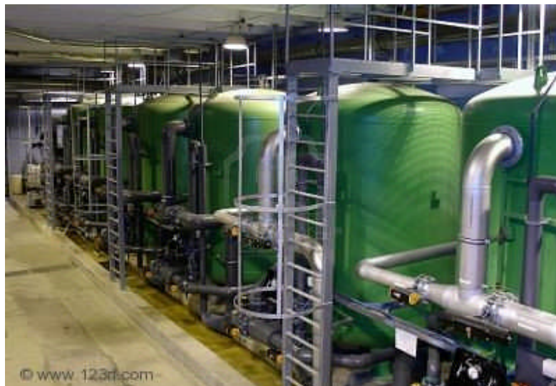
Figura 4.6 Tanques de almacenaje de fluidos (líquidos o gases) y sus respectivos ductos de entrada y salida
