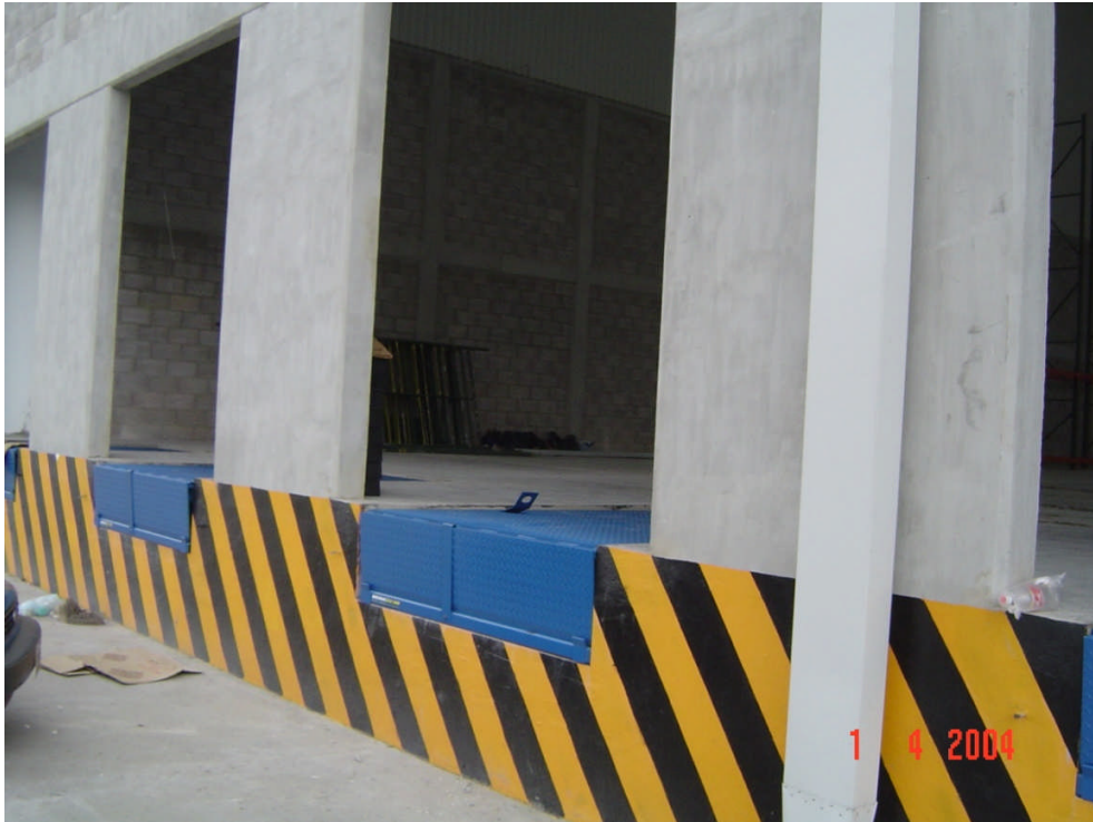
Figura 3.6. Aspecto general de las rampas niveladoras correspondientes a los andenes.
